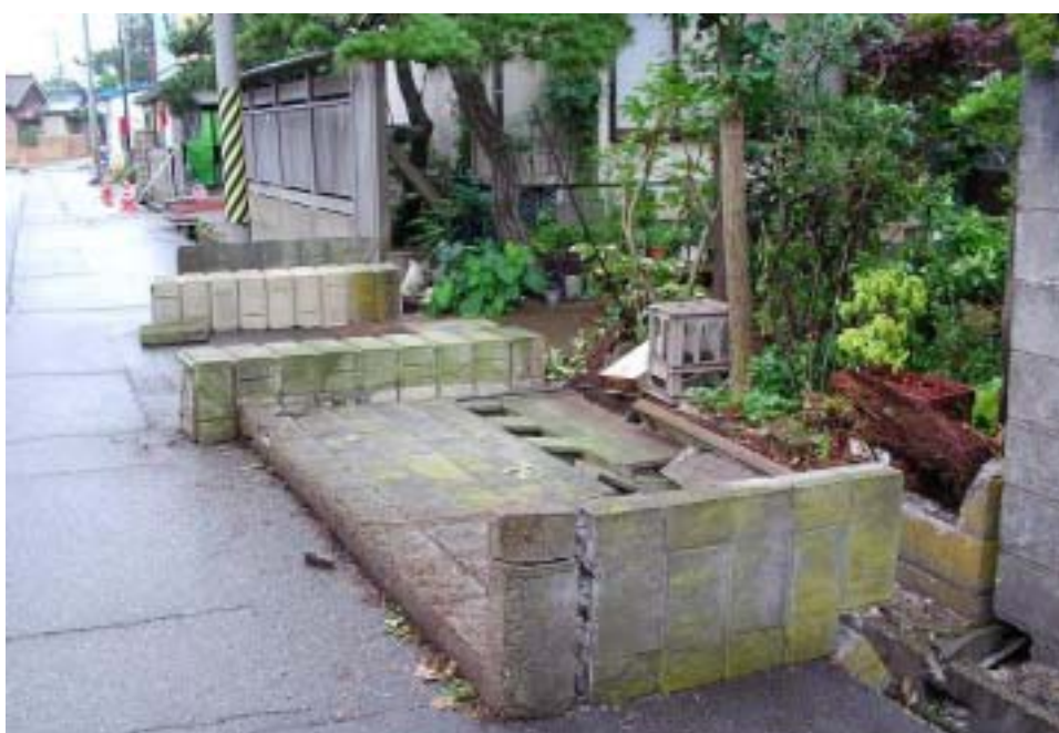
地震により、倒壊したブロック塀(平成 19 年新潟県中越沖地震) (写真提供：埼玉県)
